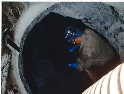
活性炭ろ過装置 活性炭抜取
